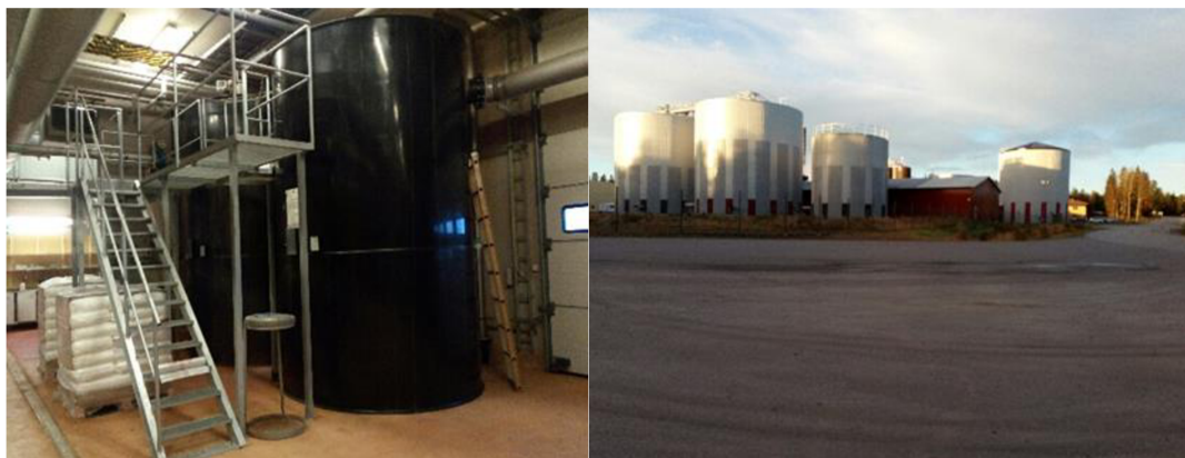
Figur 3. Biogasanläggningen med biogasreaktorer och uppsamlingstank för avloppsvatten (höger) och utrustning för blandning med FeCl_3 och PAM (vänster).
