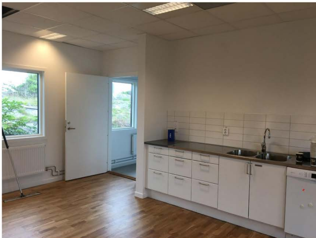
Figur 7 På bilden syns det återbrukade köket samt återbrukade radiatorer, dörrar, fönster, takplattor och armaturer.
